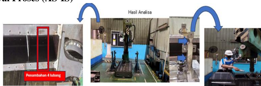
Gambar 3. Kondisi Sebelum Perbaikan
