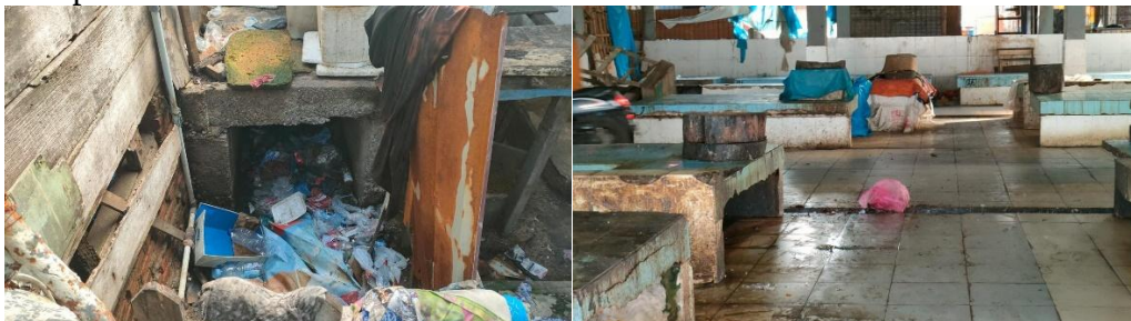
Gambar 2: kondisi area pasar ikan Pusong
