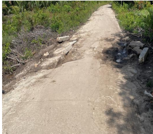
Gambar. 1 Jalan Penghubung Desa Bantan Air yang Rusak Parah saat Musim Hujan
