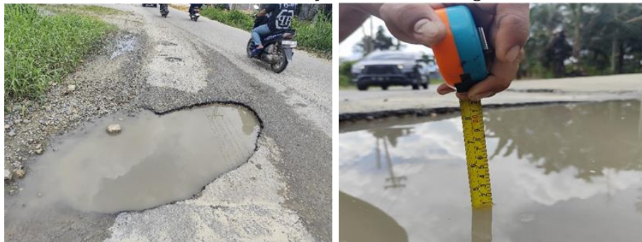
Gambar 1. 1 kerusakan jalan akibat Genangan Air
