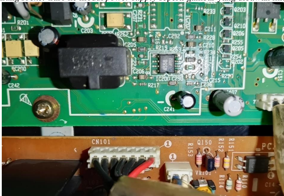
Gambar 18 Pemasangan socket CH 101 (7pin) ke modul power supply Sumber: Dokumentasi Penulis, 2024
