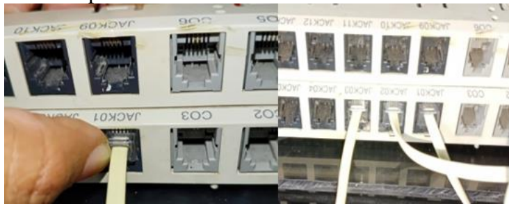
Gambar 9 Kabel RJ-11 pada PABX
