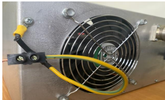
Gambar 4 Terminal Kabel Ground Pada Body Radio FM Sumber : Penulis, 2024
